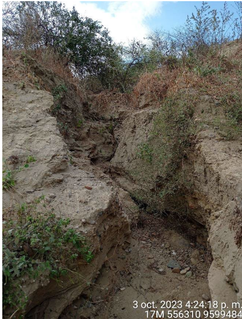
Figura 4. Erosión del talud de la margen izquierda del dique transversal 1.
